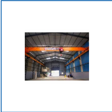
MALGUDI EOT CRANE
