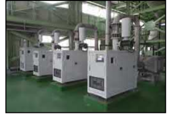
Sudokwon Landfill Site (NX150), Korea
