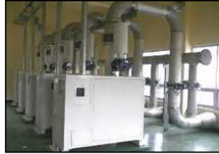
Hoeya WWTP (NX150), Korea
