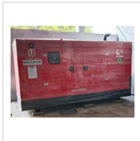
70 KVA Diesel Generator
