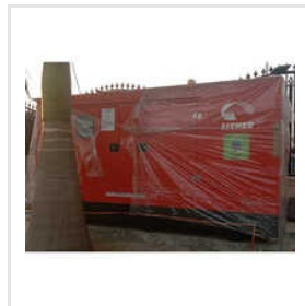
60 KVA Diesel Generator
