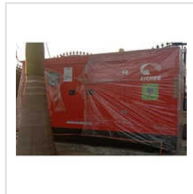
35 KVA Diesel Generator
