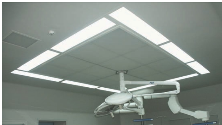
Laminar Air Flow -Diffuser
