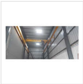
SG 5 Ton Eot Crane
