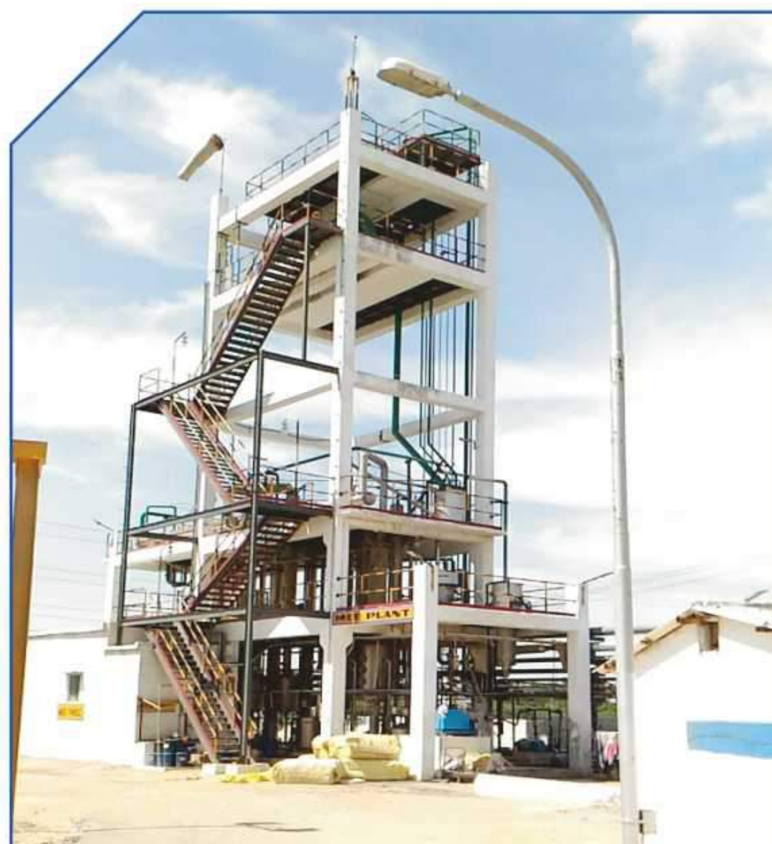
KUNNANKALPALAYAM CETP - 100 KLD
