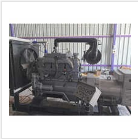
70 KVA Biogas Generator
