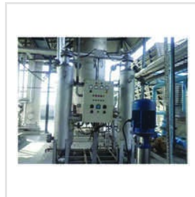
CO2 Production Plant
