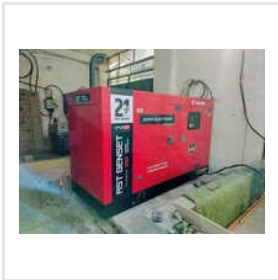
Volvo Eicher Generator
