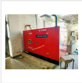
Volvo Eicher Generator
