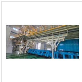
WoongBi Machinery MgO+TiO2 Mixer Line
