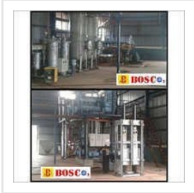
Co2 Dosing System
