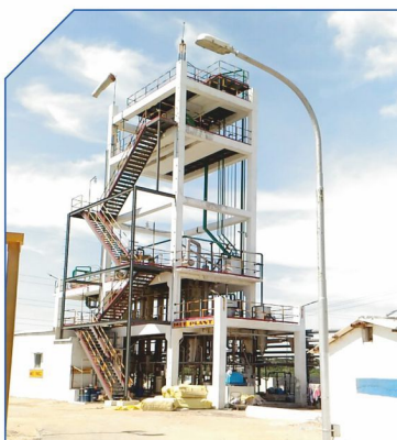
KUNNANKALPALAYAM CETP - 100 KLD
